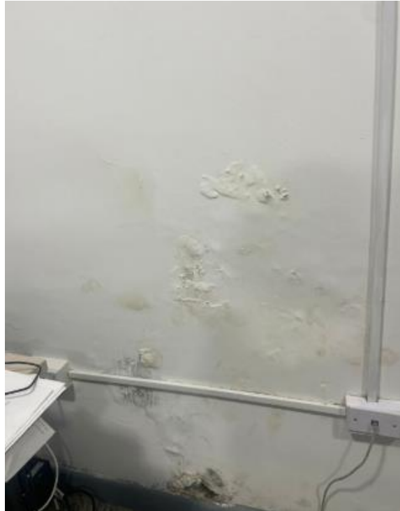
Ilustración 9: Humedades áreas administrativas
